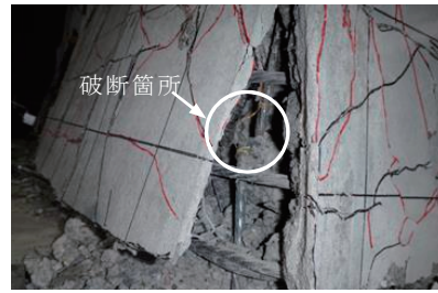
写真-5.5.1 補強軸方向鉄筋の破断状況
