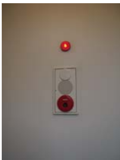
図4-7 非常警報装置
