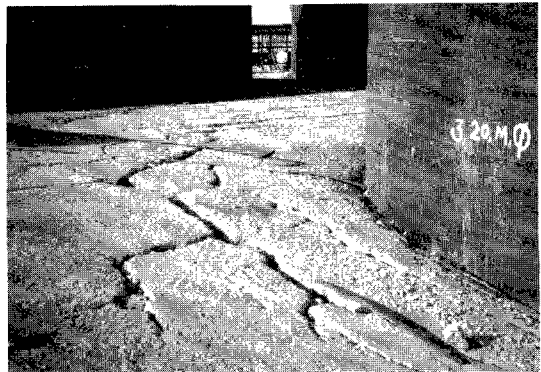
図57 図56のタンク周辺基礎地盤の被害状況
