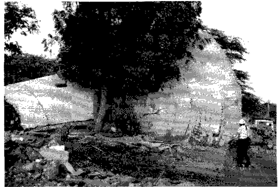
図65 Chobari の給水塔の完全倒壊
