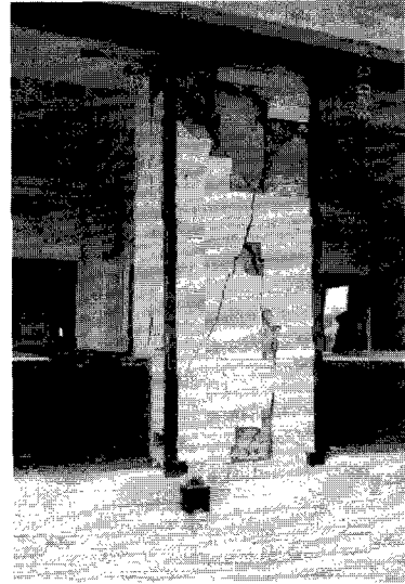
図26 図25に示した新築建物の柱の被害状況
