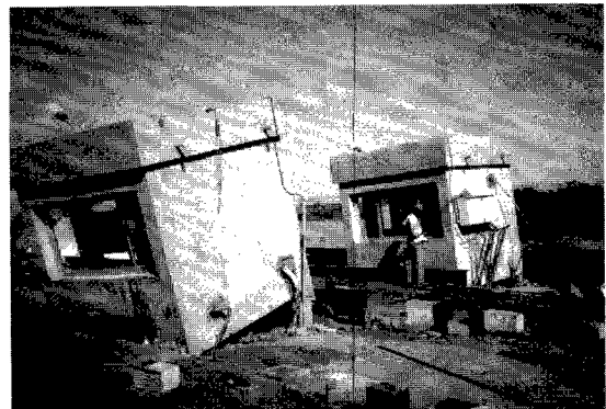
図32 高速道路5Aの通行料金徴収所の転倒
