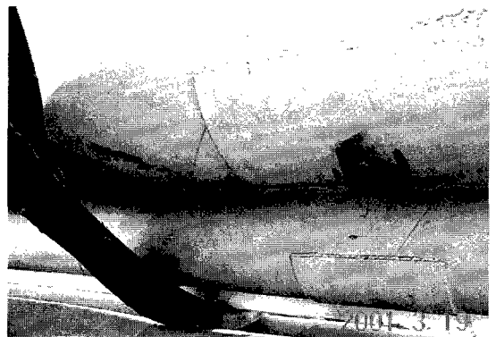
図61 図60の被害状況
