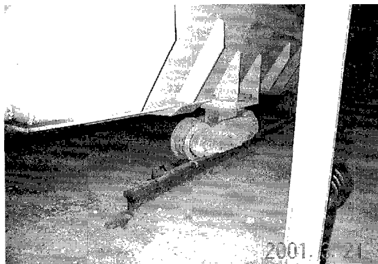
図55 変電機器の被害 (変電設備の移動)
