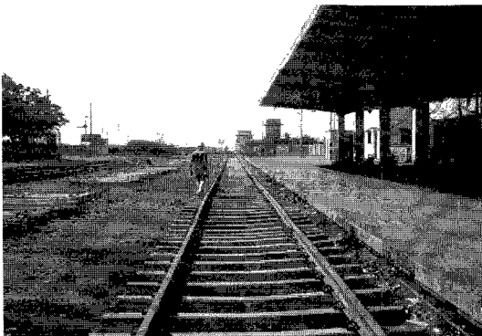
図29 Gandhidhamの鉄道の被害(レールのずれ)
