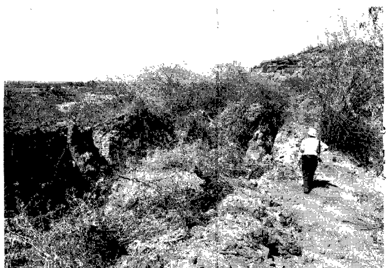
図39 Chang ダムの堤頂部の大被害(沈下約5m)
