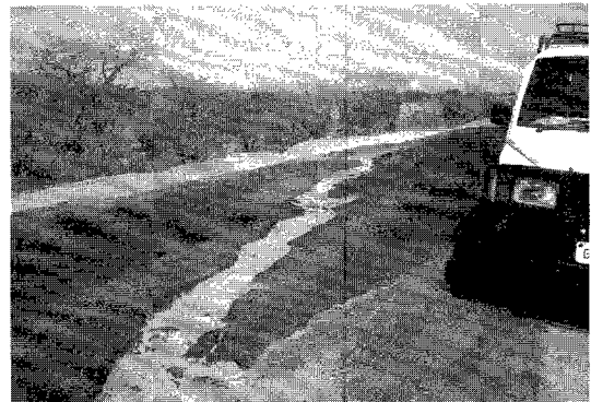
図31 地盤変状に伴う道路の被害(路面の亀裂)
