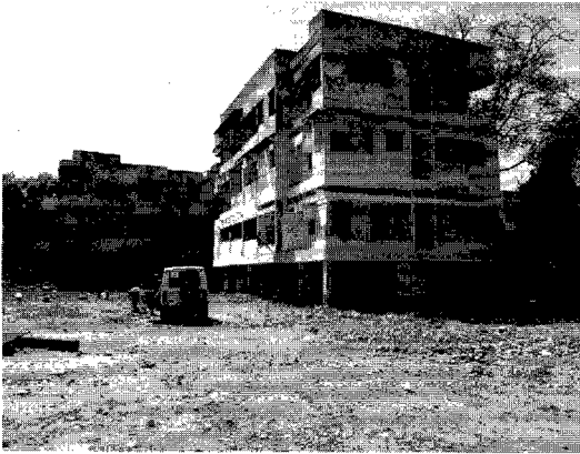
図19 Ahmedabad の4階建て建物の被害(1階がピロティー形式で全壊した建物位置で常時微動観測)
