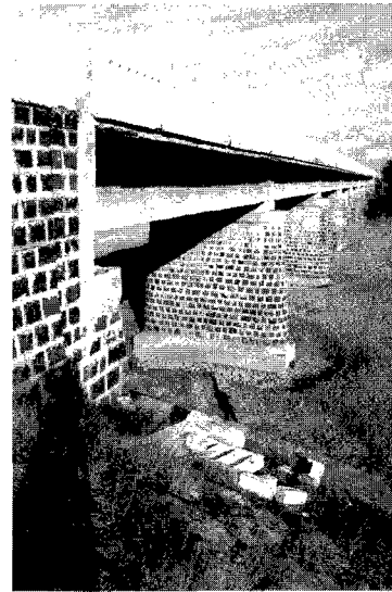
図35 Godra River に架かる Dhagadhala 橋の被害
