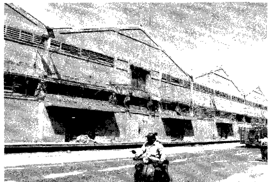
図49 Kandla 港内の倉庫の短柱のせん断破壊と鉄筋の座屈
