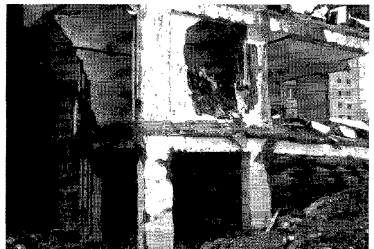
図18 Ahmedabad の4階建て建物の被害 (1階がピロティー形式)
