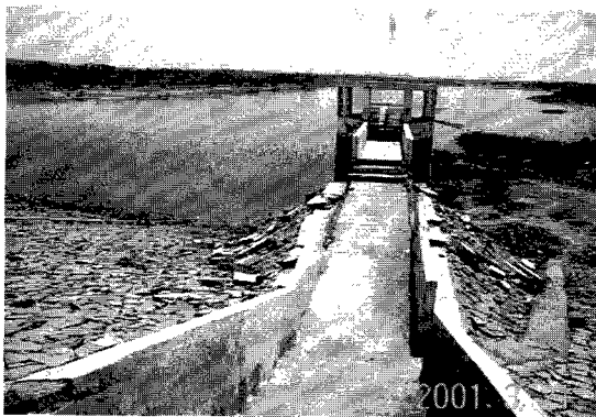
図42 Rudramata ダム取水口の被害
