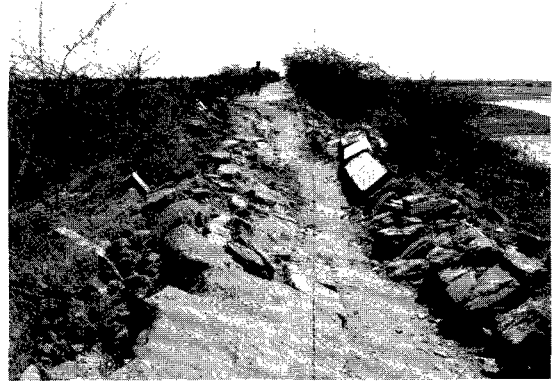
図37 Suvi ダム堤頂の沈下被害
