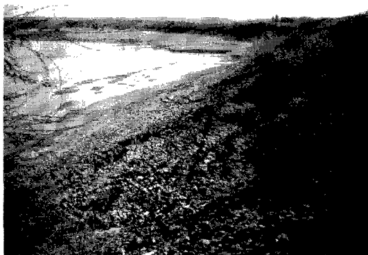
図68 液状化被害 (Chang ダムの法面のすべり破壊)
