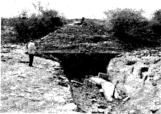
図41 Chang ダム取水口の被害
