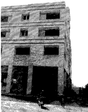
図25 震央付近の4階建て新築建物の被害 (GandhidhamのRC造建物)
