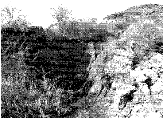
図15 断層運動に伴う地盤変状 (Chang ダム堤頂の地割れ)
