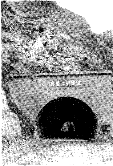
(b) 8号線：馬陵第2トンネル坑口の被害
