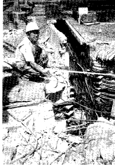
(b) 地盤の変状とコンクリートダクトの被害
