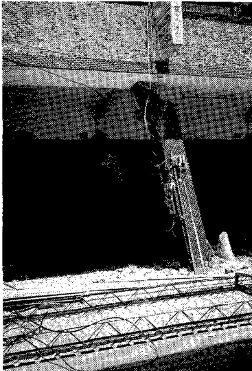
写真4 かるうじて崩壊をまぬがれた建物の騎楼部分。柱頭部分に曲げヒンジが生じている。
