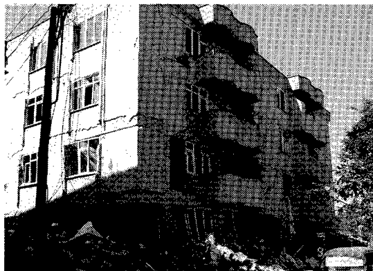
写真2 層崩壊した鉄筋コンクリート集合住宅
