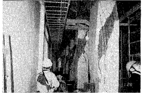
写真10 神戸高速鉄道地下鉄の被害(大開駅~長田駅間の側壁と底盤ジョイント部の破壊内側に15cm移動)
