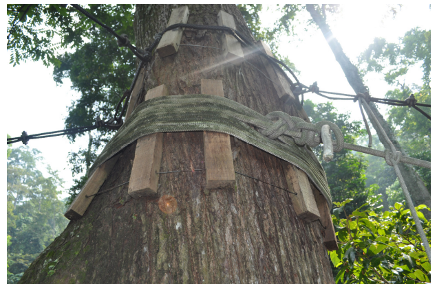
図6 キャノピーウォークウェイの支えとなる樹木。いくつかの樹木によってキャノピーウォークウェイが支えられているが、その荷重を幹上で分散させるために、写真のような工夫がなされている。しかし、その負担は大きく、定期的なメンテナンスが必要である(沼田真也撮影)。
