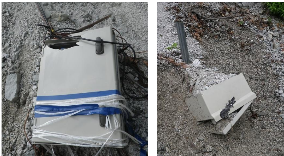
写真 2.34 斜面崩壊により破損した収納箱（左：2013年、右：2014年）
