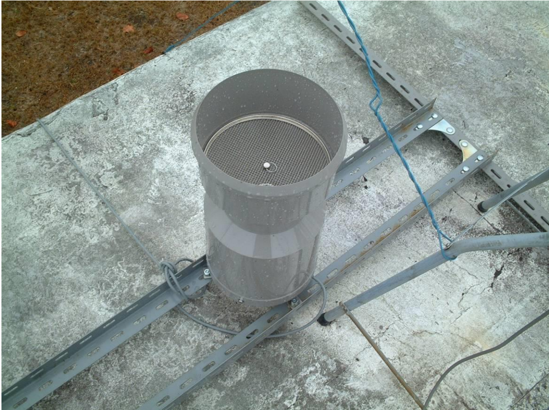
写真 3.9 設置後の転倒ます型雨量計
