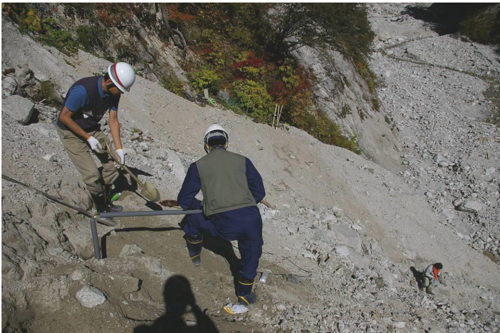
写真 2.17 テンシオメータの設置
