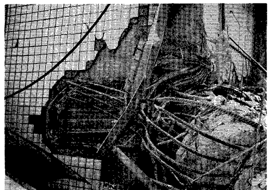
写真3 倒壊した12階建マンションの1階の柱脚部の崩壊状況（豊原市）
