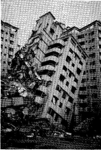
写真8 1階の柱の崩壊と上層階が地下駐車場に潜り込んだ状況（大里市）
