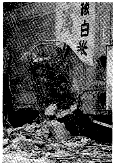
写真10 1階の柱の崩壊状況（台中市）
