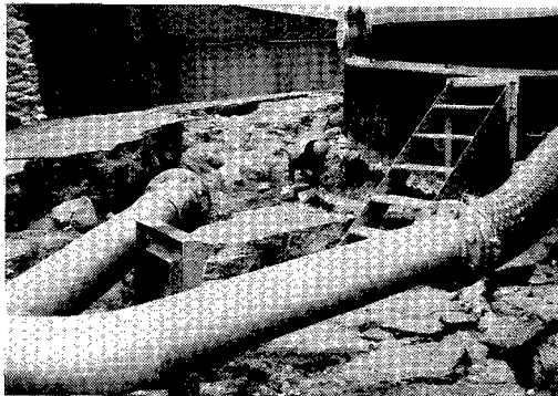
写真5 側方流動により流されたタンク下地盤 (タンクは杭により支持され沈下なし) (消防庁提供)
